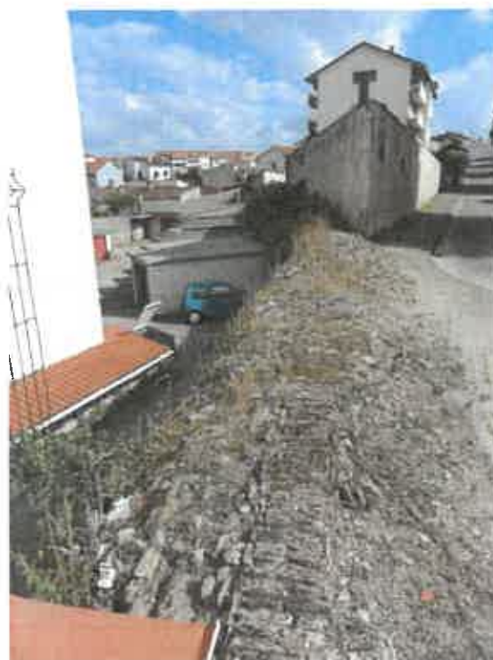
Imagem 83 – Foto das habitações que se colaram ao aqueduto no troço a seguir à intercepção com a estrada da Rua Milagres das Rosas. 131
