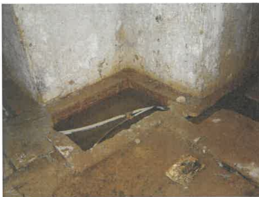
Imagem 34 - cano na mãe de água que liga a água da nascente até a uma fonte e lavadouro situados junto da estrada da Mina. 90
