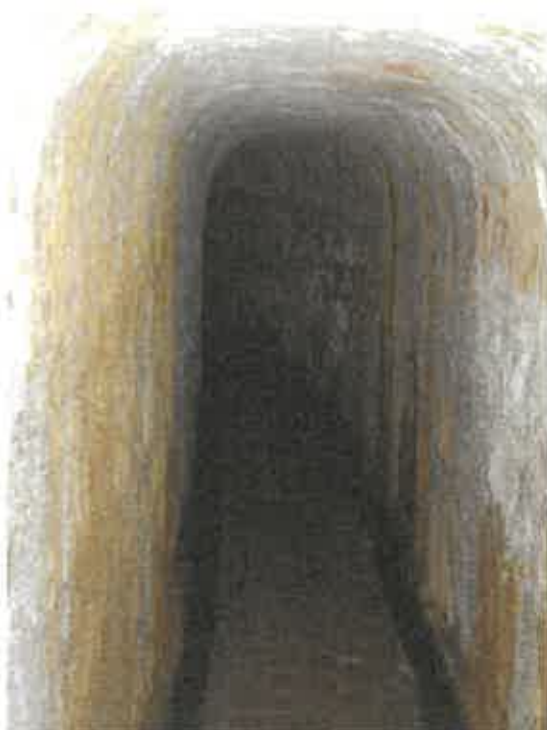
Imagem 32 - A água circula através de canais encrostados no solo. 88
